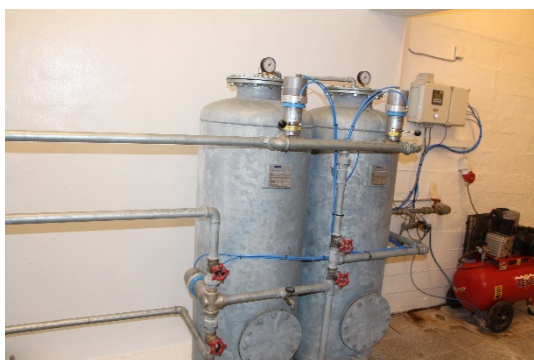
Parallelle trykfiltere på vandværket.
