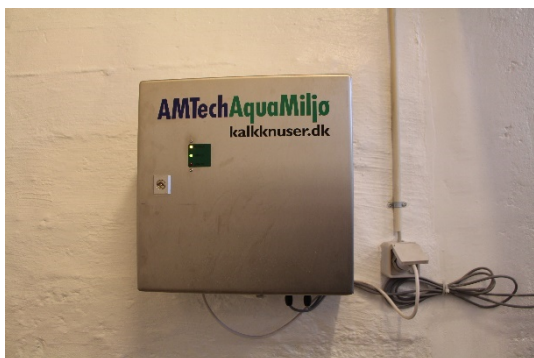
Kalkknuser installeret på vandværket.
