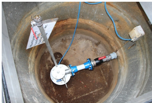
Tørbrønd med installationer.
